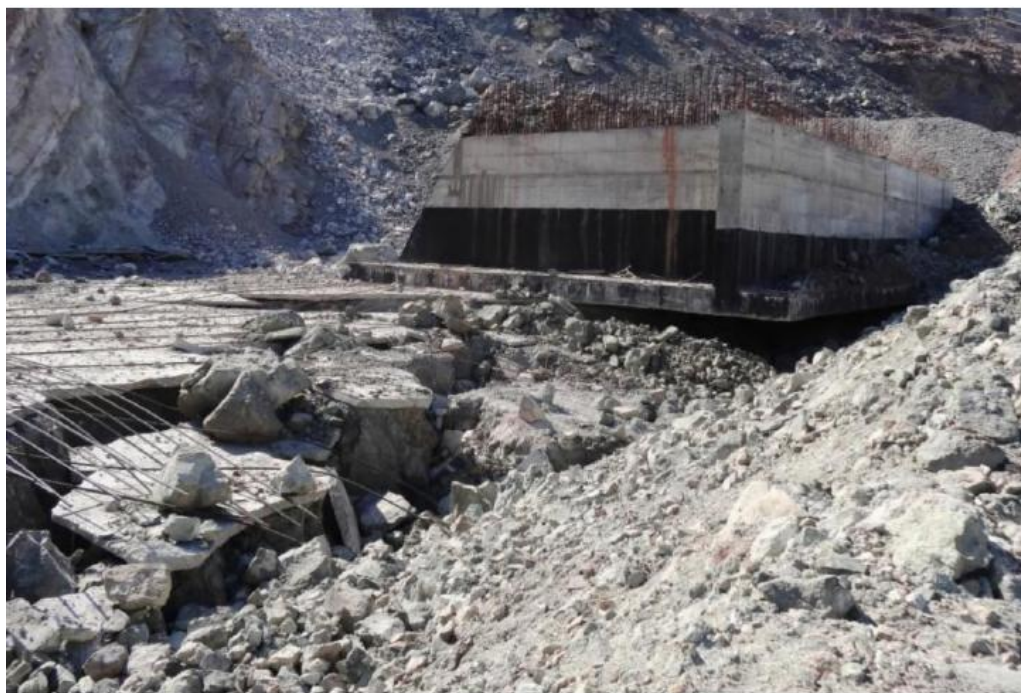
Рисунок 1.1 - Обрушение юго-западного борта Качарского карьера под строившейся подпорной стенкой на горизонте минус 30 м
